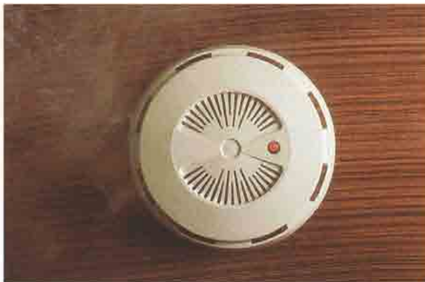
El porcentaje de instalaciones con detección automática es pequeño, siendo el detector óptico de humos el utilizado por el 24 por 100 de las empresas.
