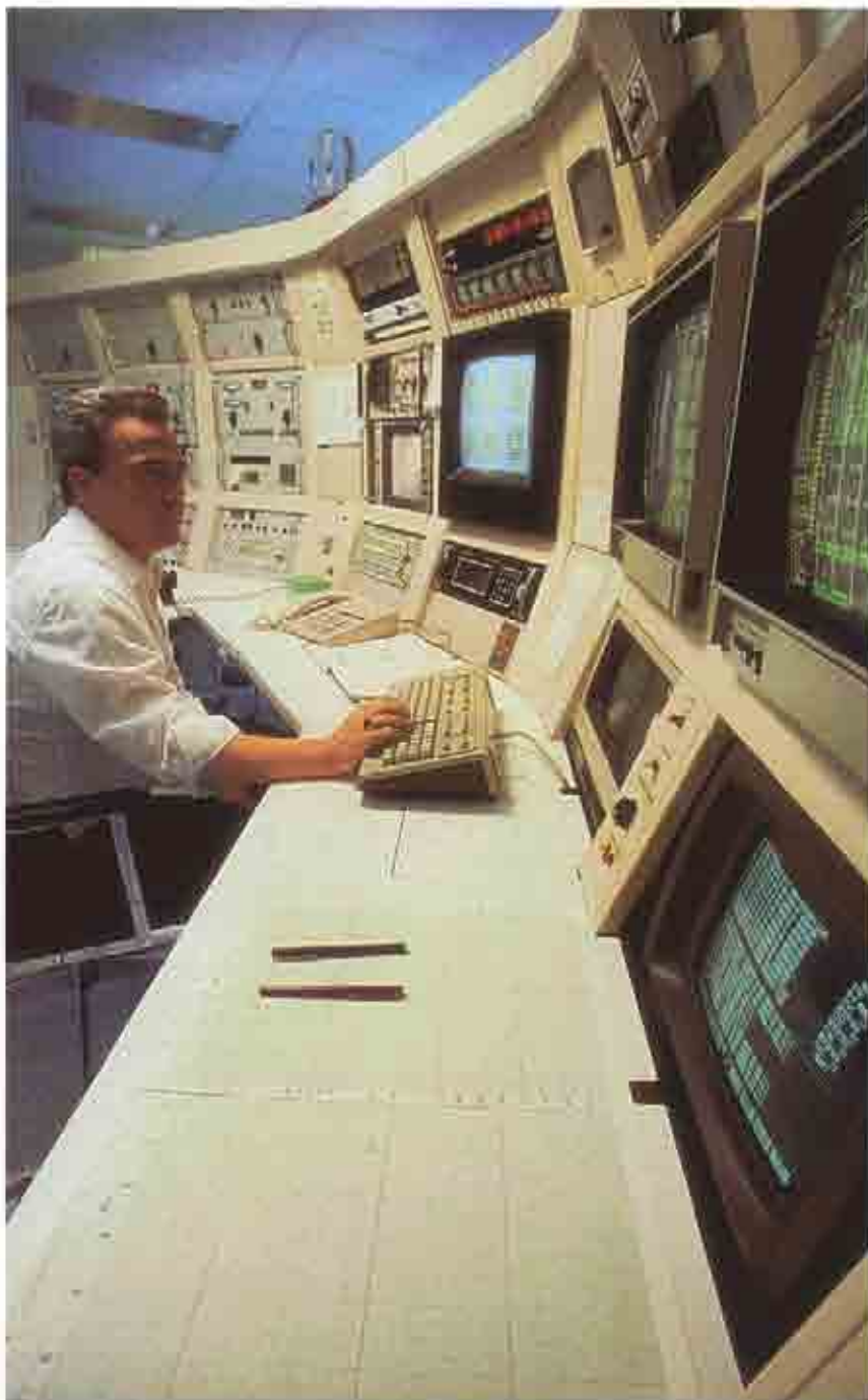
Las dos terceras partes de los sistemas de detección automática reflejados en la encuesta llevan aparejado algún tipo de accionamiento.
