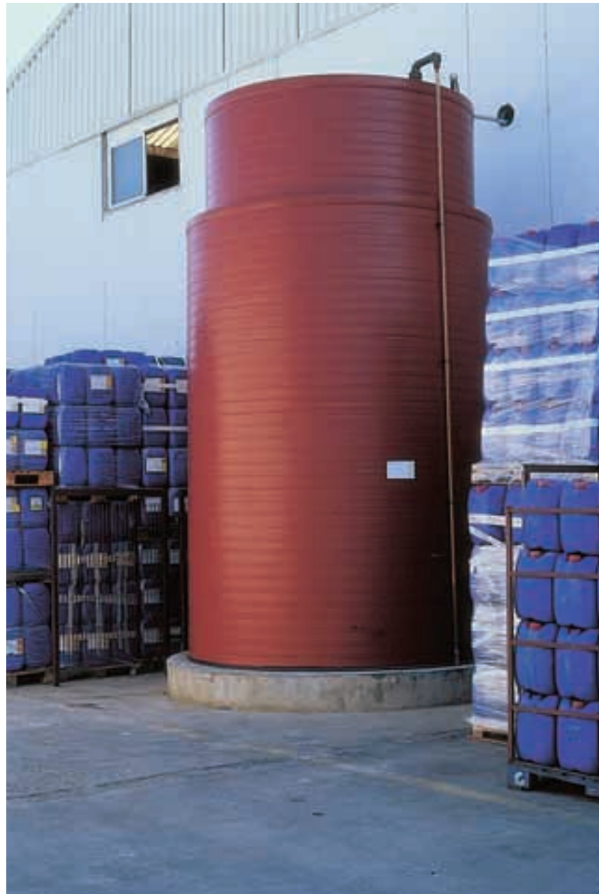
Depósito con cubeto de retención incorporado.
