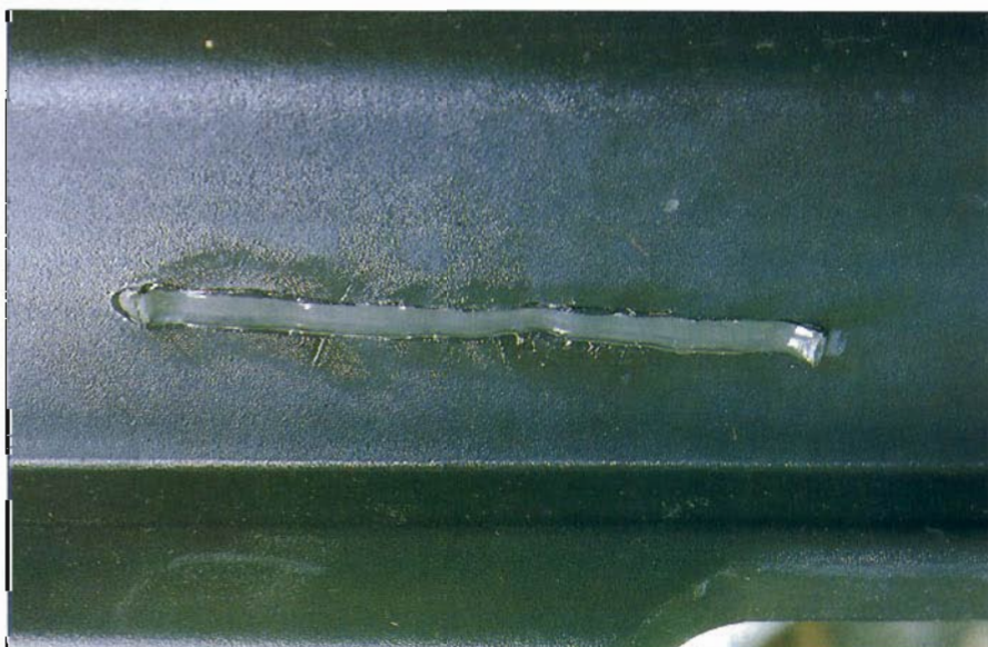
Soldadura realizada con presión excesiva sobre la varilla.
