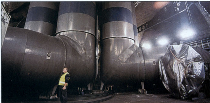
Sistemas de ventilación
