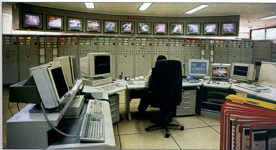
Centro de control de tráfico del túnel.
