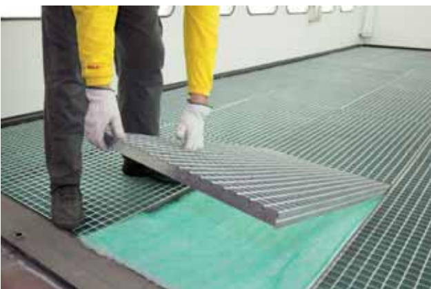
► Sustitución de filtros paint stop
