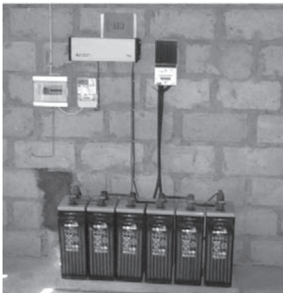
IMAGEN 5. INTERIOR DEL CUARTO TÉCNICO. ALDEA DE FOURDOU (FOTO EXTRAÍDA DEL INFORME DE LA ASER).
