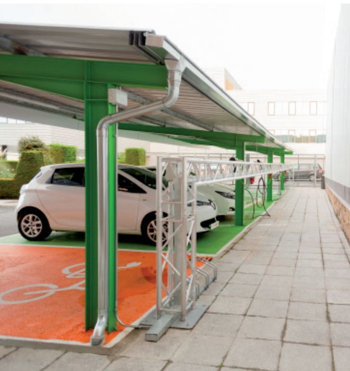
► Estructura modular donde se instalan los cargadores
