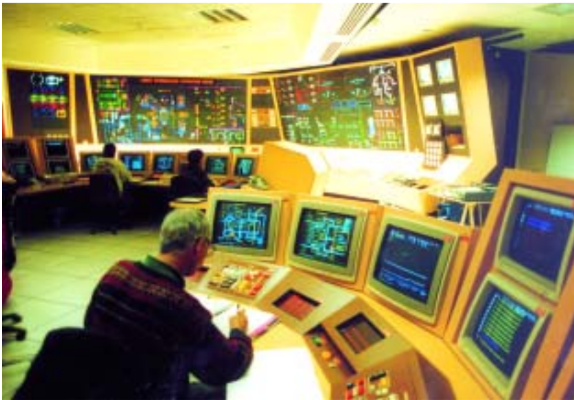
Sala de Control de una central nuclear
