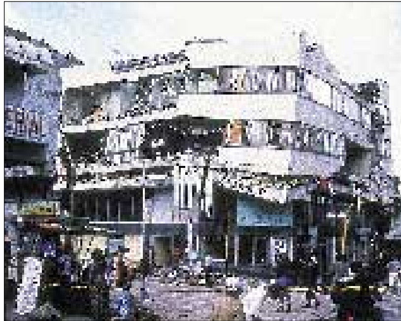
Colapso de una edificación antigua construida sin requisitos sismorresistentes en Armenia, Colombia.
