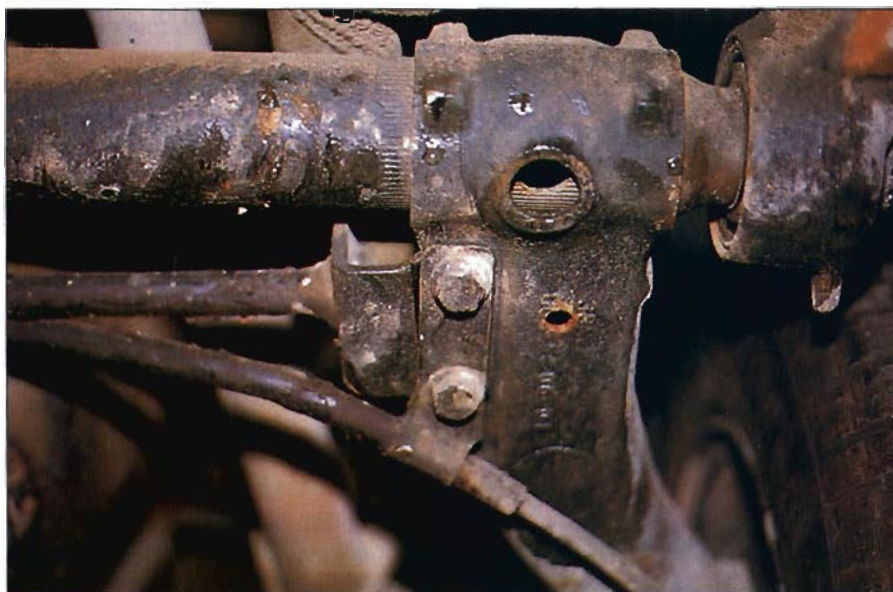
Las zonas limpias de los anclajes de elementos mecánicos delatan un desplazamiento.
