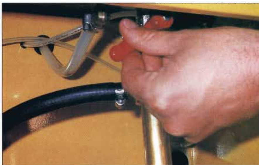
Válvula manual de vaciado.
