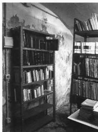
Filtraciones de agua causadas por mal estado de las cubiertas
