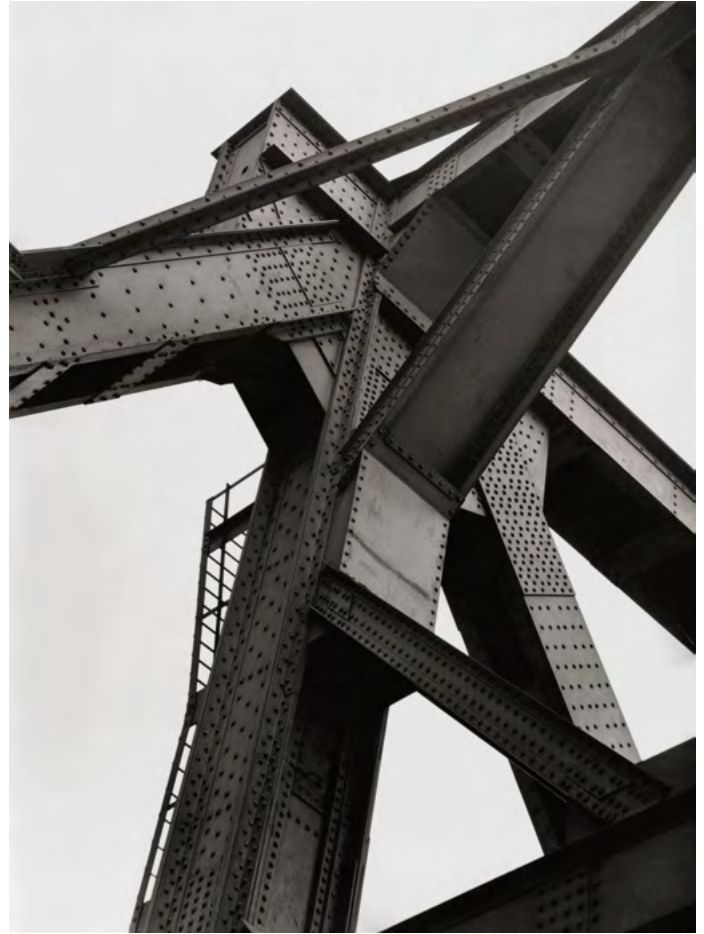
Albert Renger-Patzsch, Un nodo del puente de celosía de Duisburgo-Hochfeld [Ein Knotenpunkt der Fachwerkbrücke Duisburg-Hochfeld], 1928. © Albert Renger-Patzsch / Archiv Ann und Jürgen Wilde, Zülpich / VEGAP, Madrid 2017
