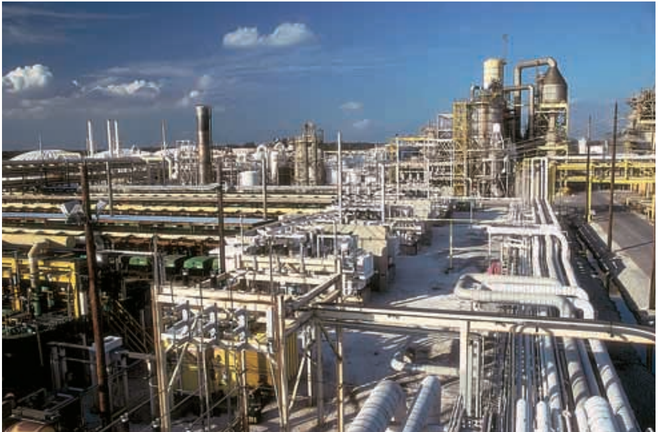
Los estudios de evaluación de riesgos y de diseño de instalaciones y equipos que manejan cloro, así como las normas de mantenimiento y operación, deben examinarse en profundidad para minimizar los riesgos.
