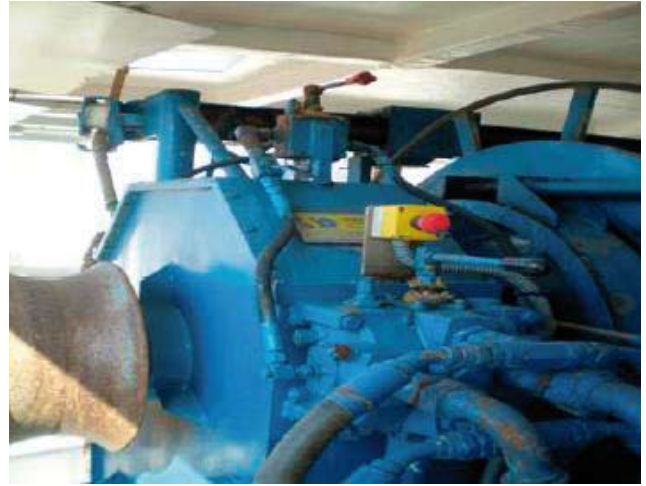
Ilustración 3b. Paro de emergencia
