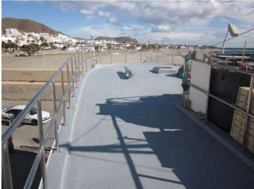
Ilustración 1. Protección con barandilla de 1 metro de altura
