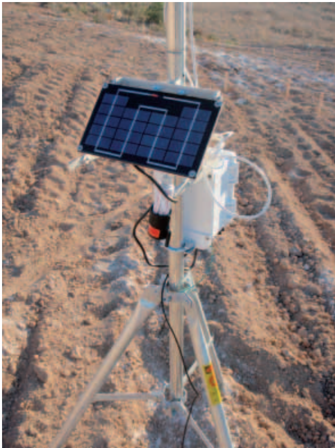
Figura 20. Dataloger y placa solar.
