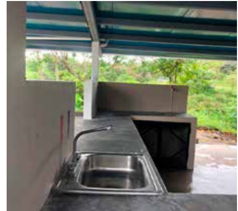
Detalle de la cocina comunitaria para los habitantes de Hato Chamí, en Panamá
