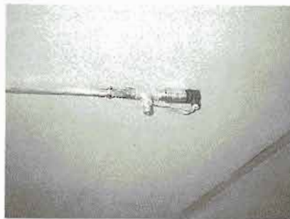
FOTO 5 Detalle de difusor con transductor.
