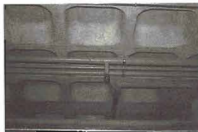
Derivaciones de flujo en plano vertical, prohibidas en la mayor parte de los casos.
