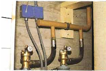
Mala ejecución y soporte en el tendido de tuberías. El sistema de disparo mediante pirotécnico no es adecuado y menos en sistemas centralizados.
