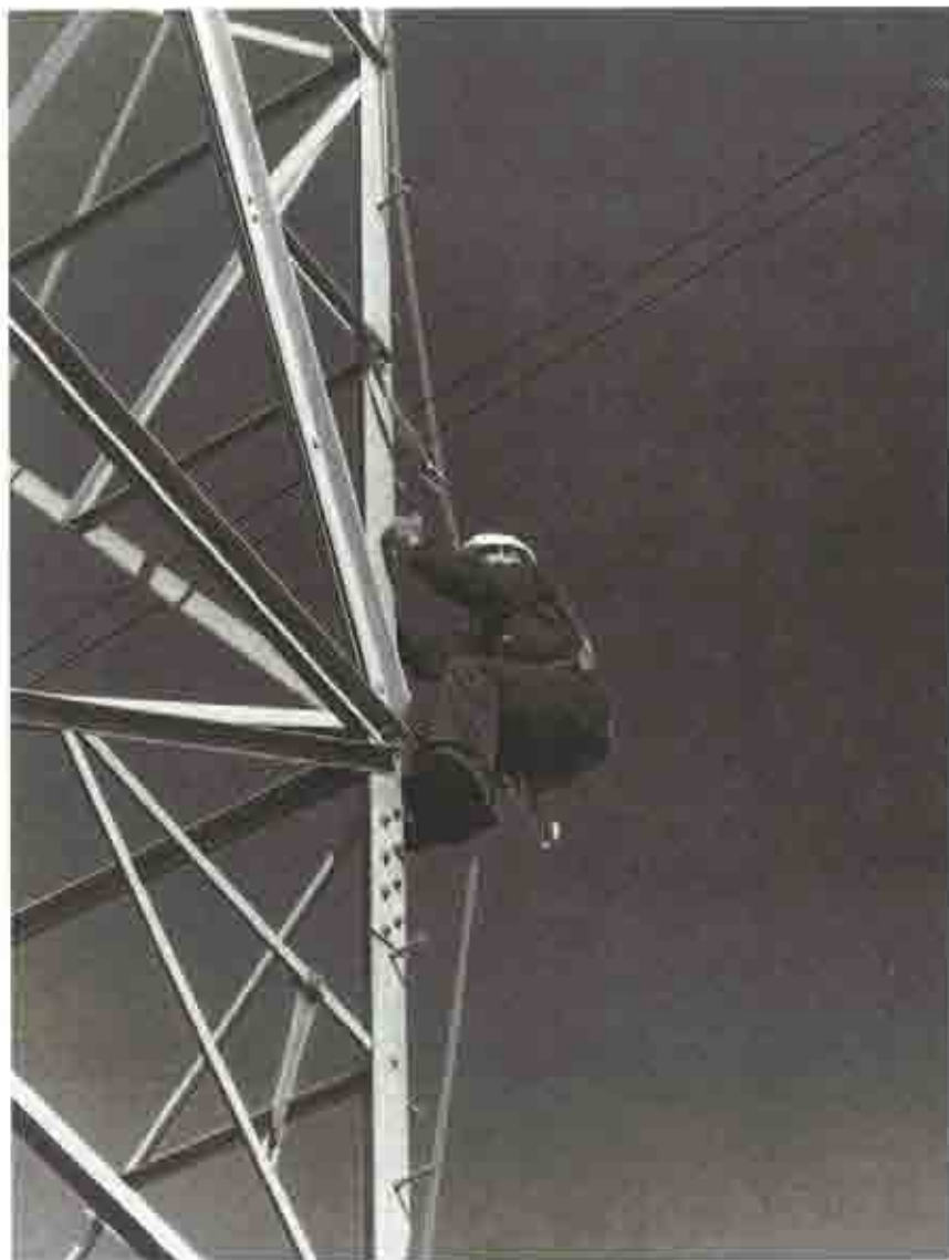
FIGURA 2. El operario que sube en segundo lugar utiliza el dispositivo anticaída de inercia «PANDA», a la vez que va liberando los mosquetones de las cintas de anclaje.
