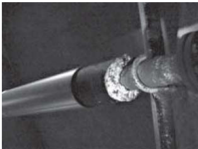
Figura 8 Calorifugado (aislante térmico en conducto de agua caliente)
