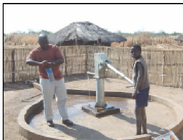
Pozo con bomba (Mozambique)
