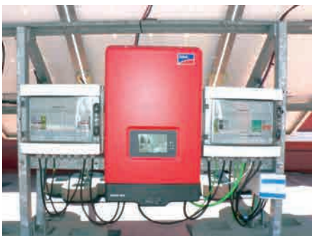
Figura 22. Caja de corriente continua, inversor y caja de corriente alterna. Fuente: elaboración propia.
