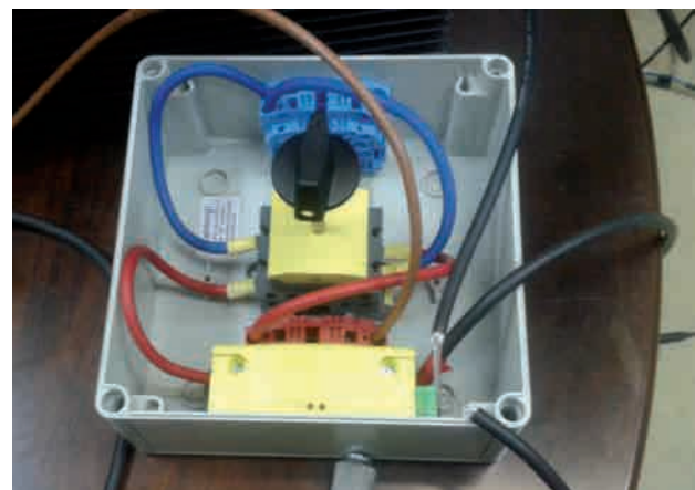
Figura 11. Imagen del detector de arcos ensayado ubicado en la caja de protección IP65, donde se incluye un interruptor manual de corriente continua (32A/1000V).
