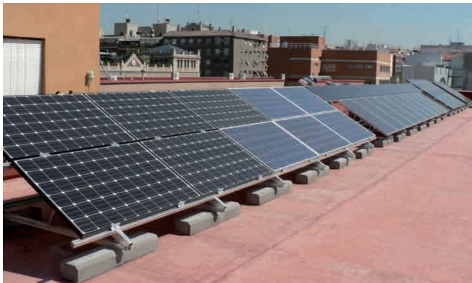
Figura 1. Instalación fotovoltaica de tipo general sobre cubierta plana de la Escuela Técnica Superior de Ingeniería y Diseño Industrial, Universidad Politécnica de Madrid. Fuente: elaboración propia.
