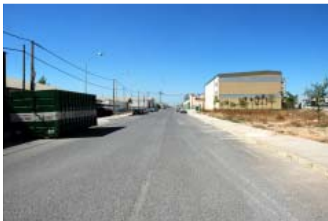
Ausencia de marcas viales
