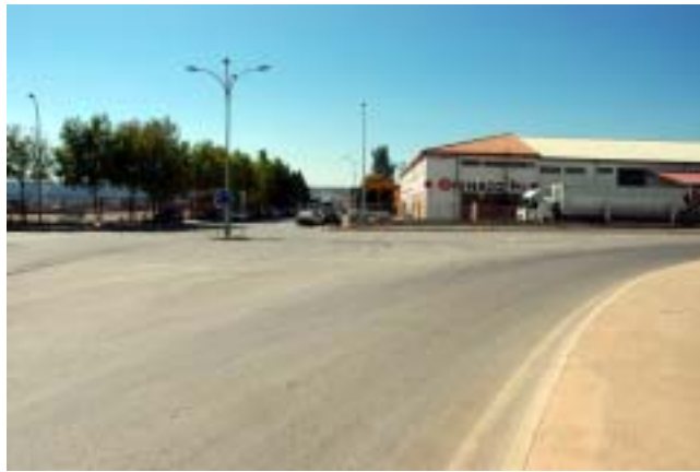
Ceda el paso en deficiente estado de conservación
