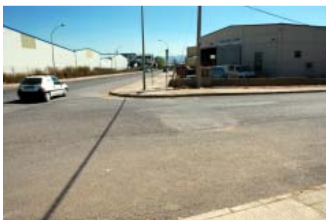
El Ceda el Paso no se encuentra señalizado con marcas viales
