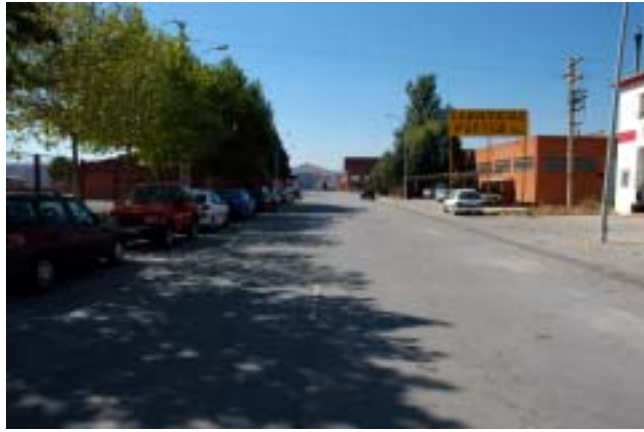
Marcas viales en deficiente estado de conservación
