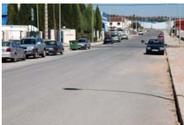
Ausencia de marcas viales
