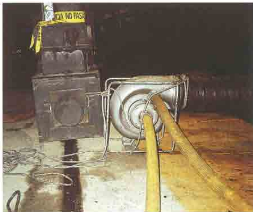
Ventilador con manguera de impulsión de aire limpio.
