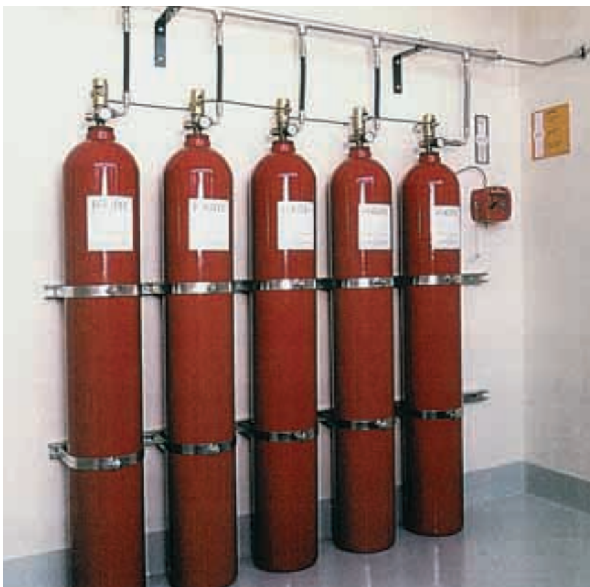
FIGURA 9. Batería de botellas de nitrógeno para equipos de extinción autónomos o de apoyo para caso de falta de corriente.
