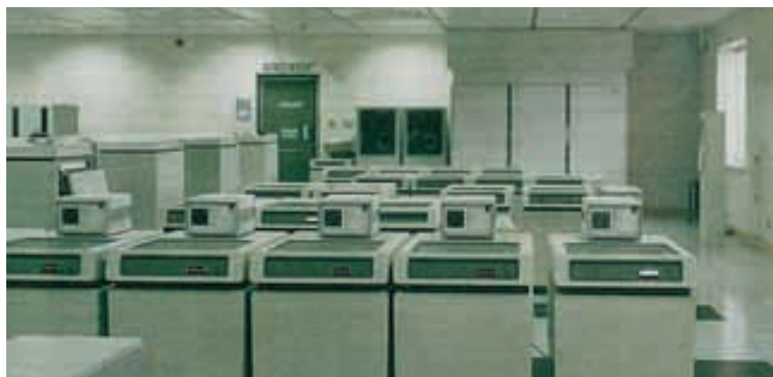
FIGURA 1. Las salas de ordenadores constituyen una de las aplicaciones más típicas de los equipos de detección por aspiración dada la necesaria precocidad que se necesita.
