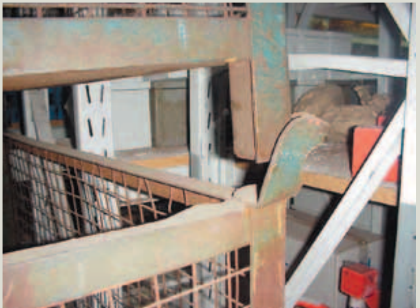
Orejera en mal estado.
