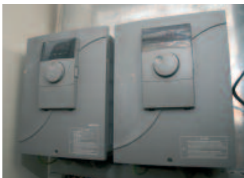
Variadores de frecuencia de la cabina
