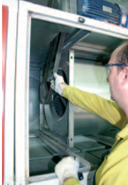
Correa de transmisión entre el motor y la turbina de la cabina
