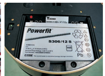
Batería, en la base del brazo medidor
