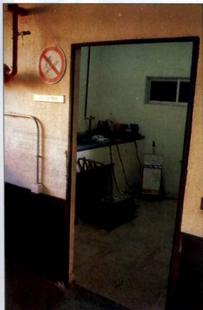
Sala de carga de baterías
