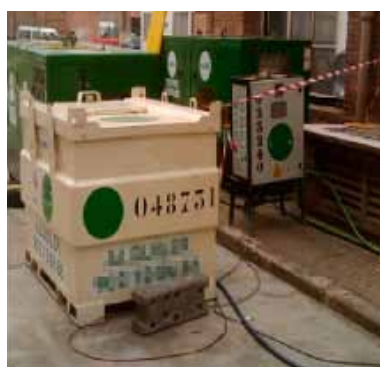
Figura 6. Generador eléctrico de emergencia
