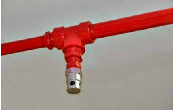
Figura 3. Difusor de descarga y canalización del gas
