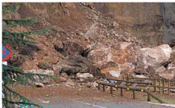
Vista del desprendimiento de rocas que ha cortado el acceso por carretera y cremallera
