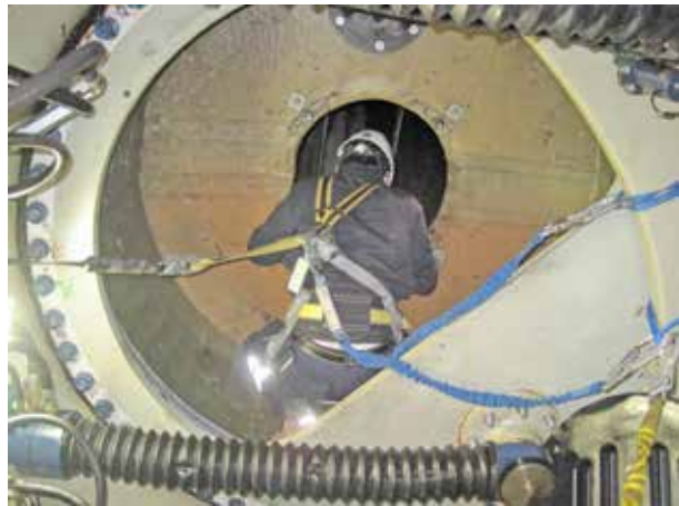
Figura 9. Acceso a palas.
