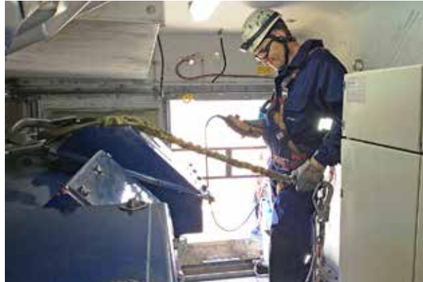
Figura 1. Puerta trasera en la nacelle con polipasto
