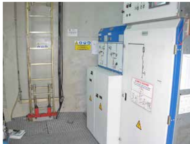
Figura 3. Celdas de alta tensión en la base
