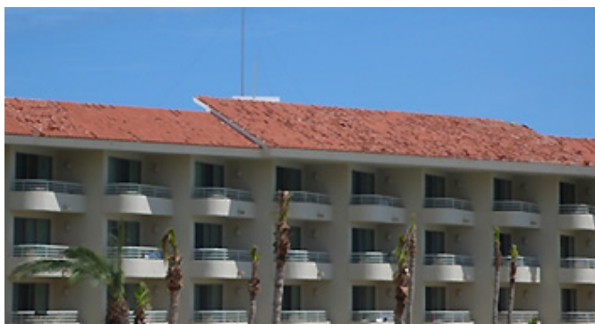
Telhas tradicionais levantadas pela força do vento.
