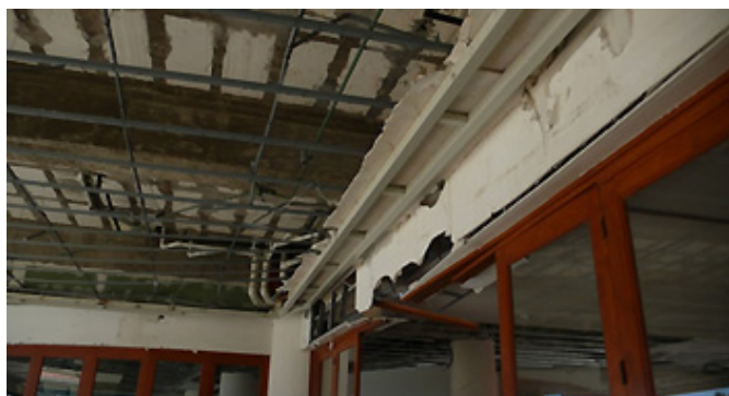
Placas de tablaroca afetadas em fachada.
