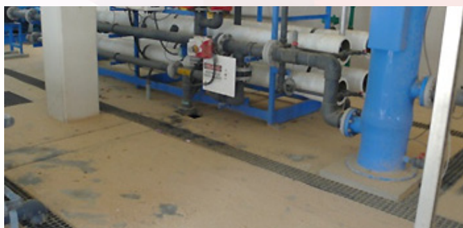
Estação dessalinizadora de hotel afetada pela entrada de água salgada e areia.
