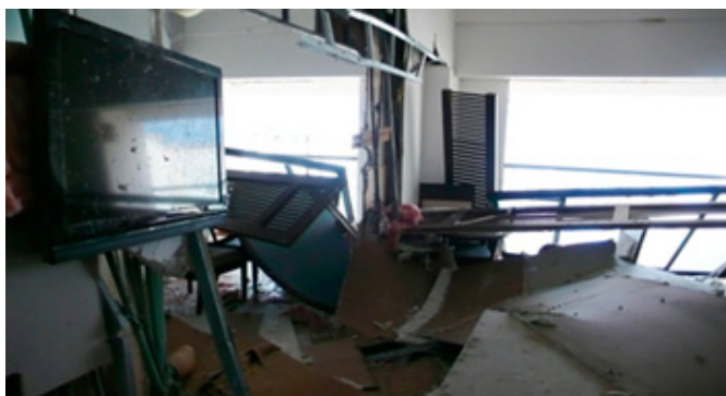
Daños en el interior de una habitación.
