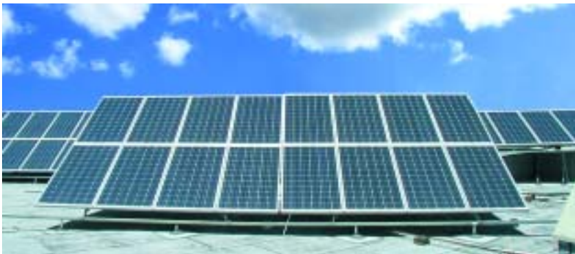
Instalación de captación de energía solar mediante paneles solares
