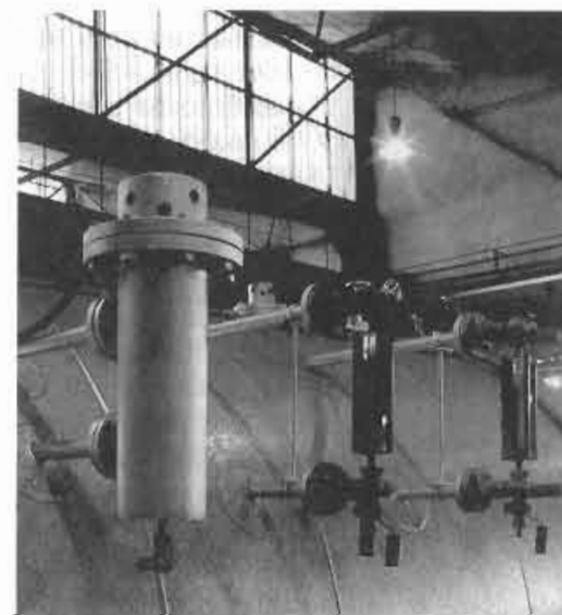
Fotos 4 y 5. Control de nivel de agua
