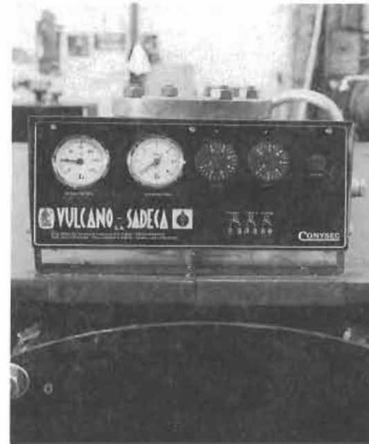
Foto 18. Caldera de agua caliente (de izquierda a derecha): 1 termostato, 1 termómetro, 2 hidrómetros y 1 válvula de seguridad (rearme)
