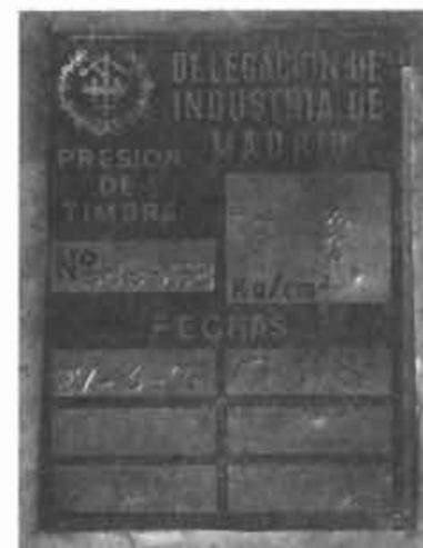
Foto 31. Placa de timbre o de instalación
