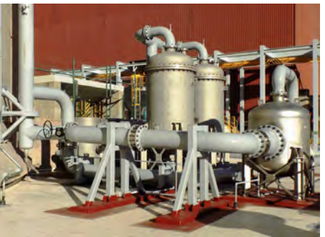
Ventoe filtrado de la contención. C.N. Cofrentes.
