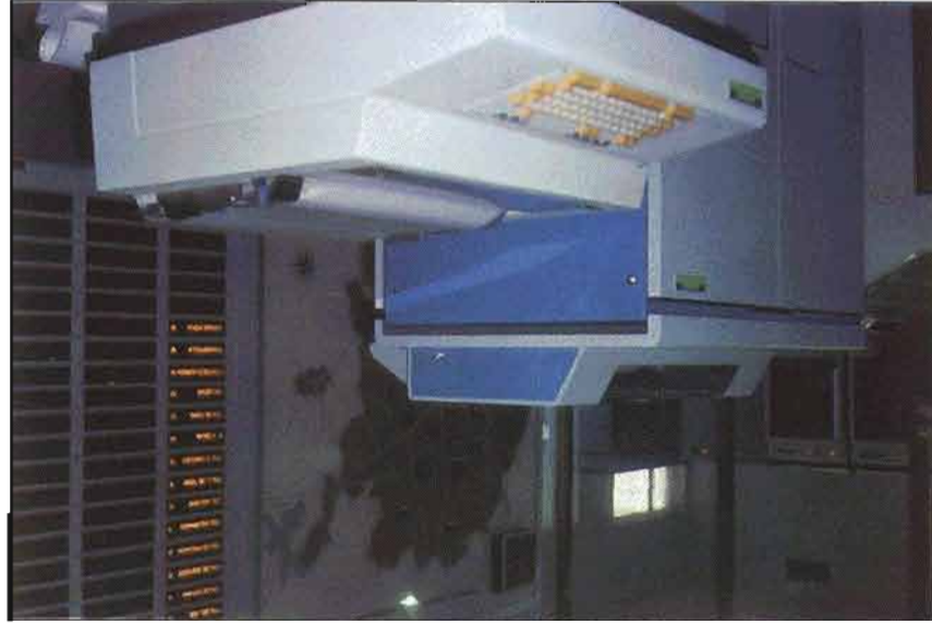
Vista parcial de la Estación Central de Control de la Contaminación.
