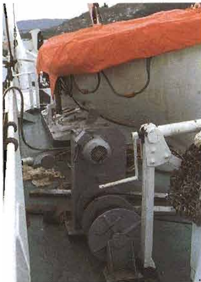
Chigre eléctrico de izado del bote. Maniela para abatimiento manual del pescante. Aparecieron problemas en el embrague del chigre. Mantenimiento escaso de las tiras y pastecas.
