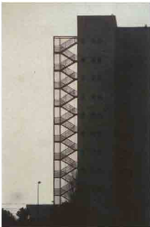
Figura 3. Con la entrada en vigor de la NBE-CPI, las escaleras de emergencia entraron a formar parte habitual del panorama urbano.
