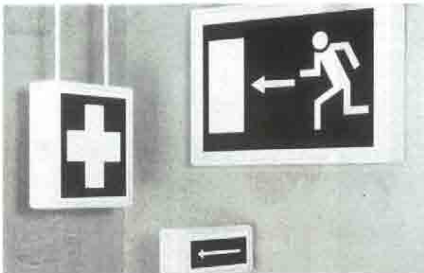
Figura 5. Una adecuada señalización asegura que la evacuación se realizará de forma correcta. (Cortesía de Odel-lux.)
