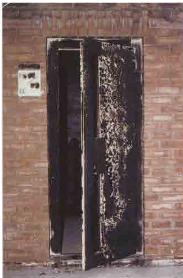
Figura 4. Las exigencias de resistencia al fuego para las puertas de paso entre dos sectores de incendio son inferiores a las que piden al elemento separador. (Cortesía de AFITI-LICOF.)
