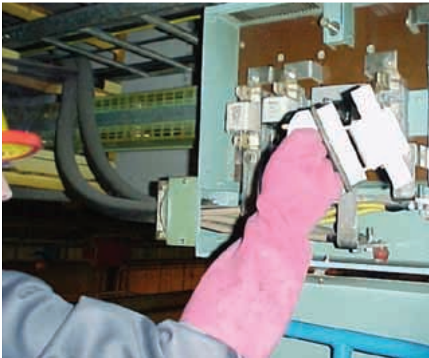
Figura 13. Sustitución de fusibles utilizando la maneta portafusibles.
