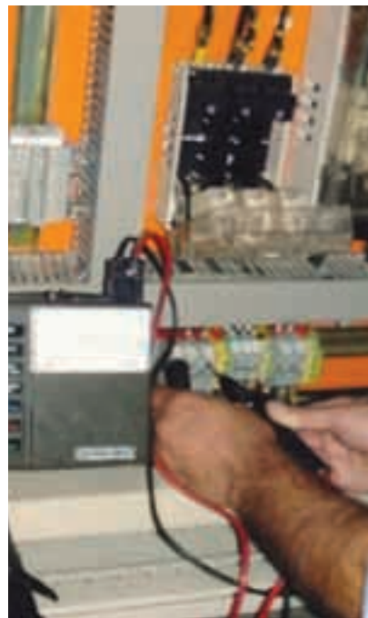
Figura 8. Comprobación del aislamiento de la acometida.
