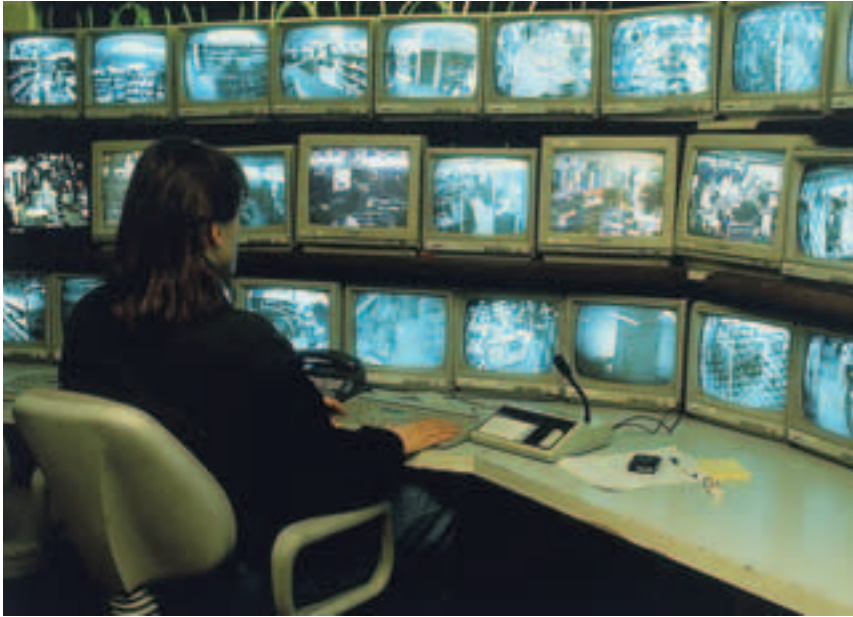
Instalaciones de protección contra intrusión: instalaciones de detección, alarma e intervención.
