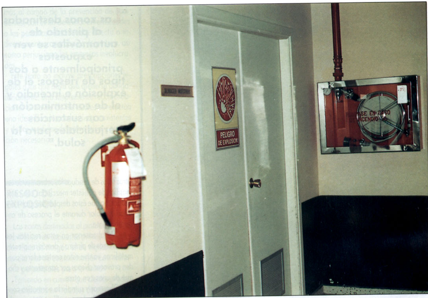
Equipos de extinción de incendios.
