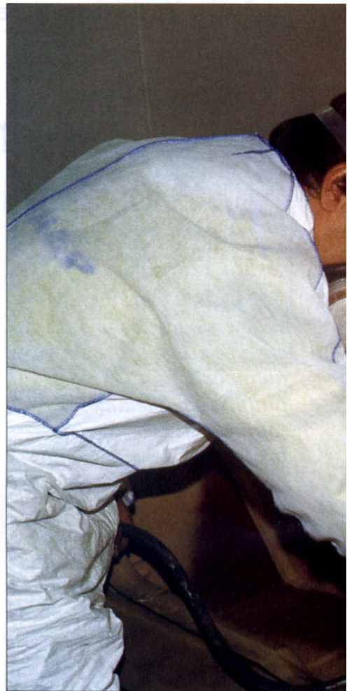
La pulverización de pinturas produce nubes tóxicas.
