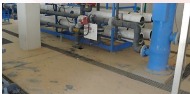
Planta desaladora de hotel afectada por la entrada de agua salada y arena.
