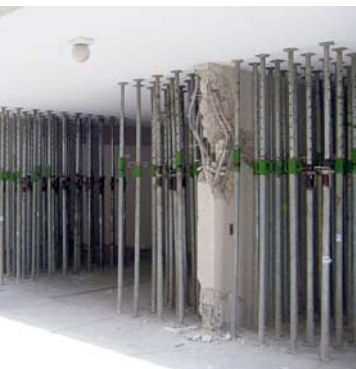
Figura 9. Daños severos en los muros de cortante (Fuente: AIR)
