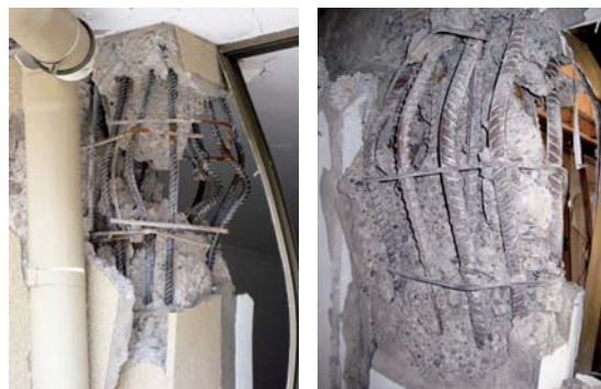
Figura 10. Gran pandeo de las barras de refuerzo vertical, agravado por la falta de suficiente refuerzo lateral o confinamiento (Fuente: AIR)
