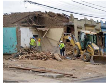
Figura 6. Desplome y demolición de estructuras de ladrillo de adobe en Talca (Fuente: AIR)
