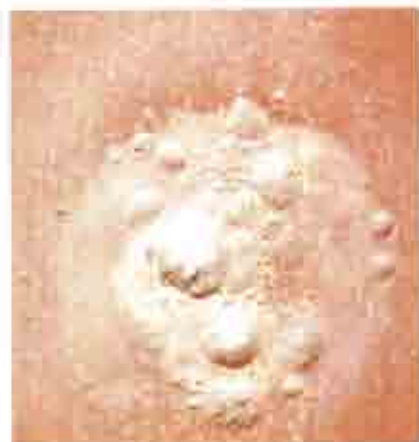
FIGURA 5. El color y extensión del ampollado son buenas pistas para orientarnos hacia el foco del incendio.
