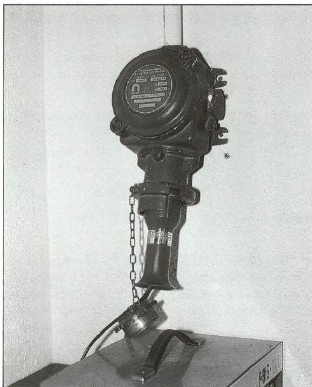
FIGURA 3.—Toma de tierra antideflagrante.
