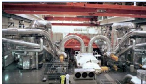
Sala de turbina en Oskarshamn 3 (Foto: OKG)
