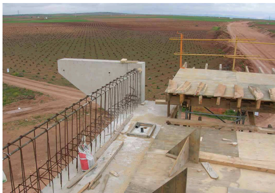
Ilustración 5. Restos de madera utilizada para encofrados en construcción de puente.
