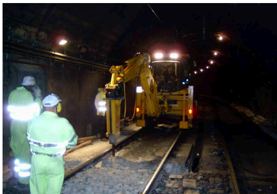
Ilustración 9. Trabajadores expuestos a humos diésel en el interior de túnel.
