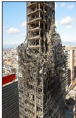
Torre Windsor (Madrid) tras el incendio
